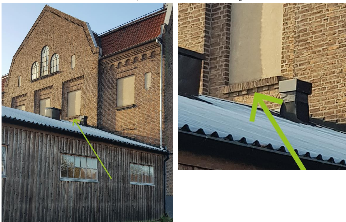
Nocken på trädelen och de (igensatta) fönster som nocken inte bör dölja. Gröna pil pekar på nederkanten av fönsteromfattningen.
