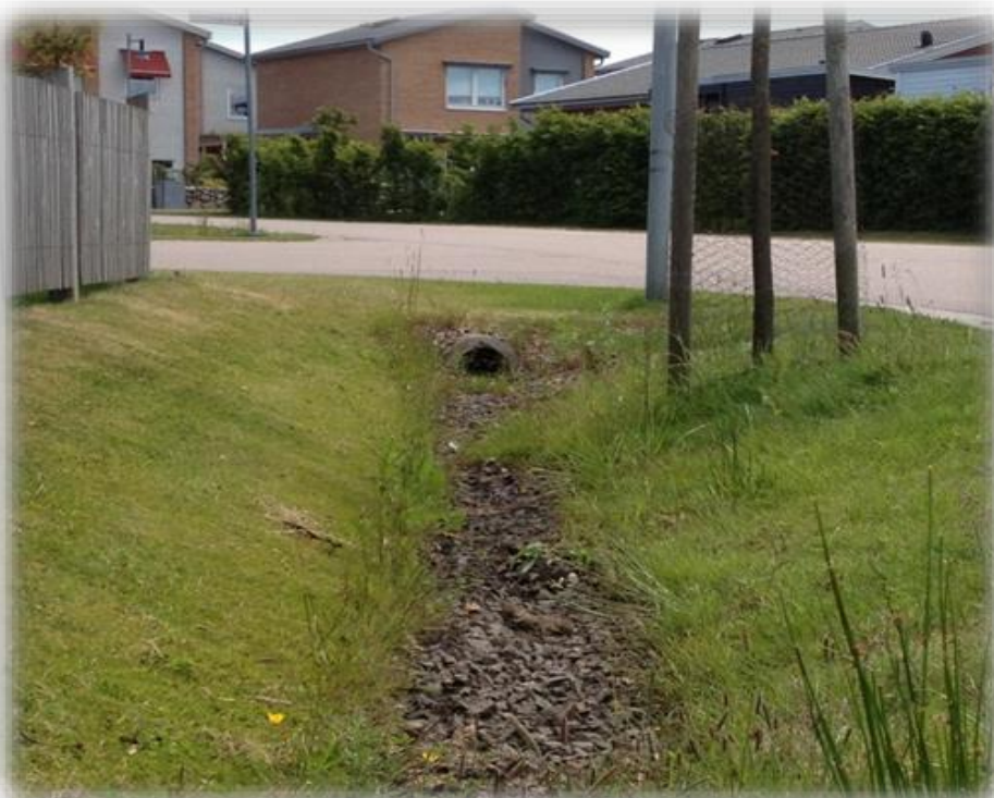
Figur 4. Bilden visar dike för vägavvattning mm med makadam i botten.
